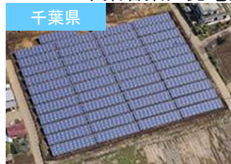
S-03 LS千葉若葉区発電所
